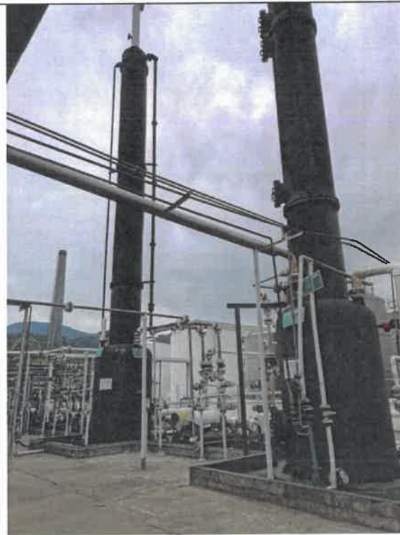
盐酸、氟化氢尾气吸收塔
