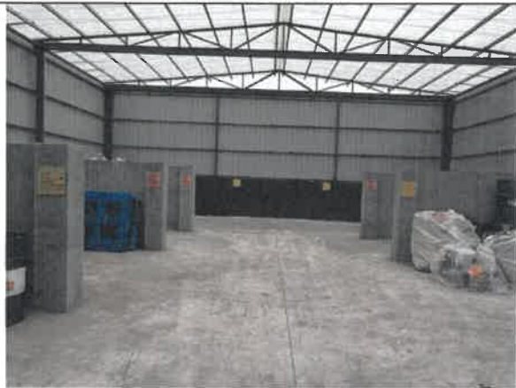
危险废物暂存间
